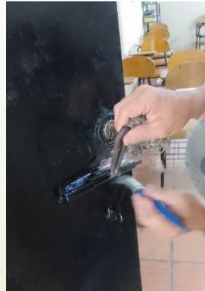
Instalación de pasador para puerta. (Salón bloque trasero de la sede primaria).
